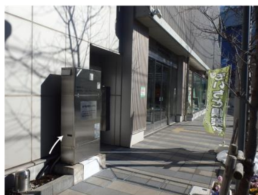
手前のステンレス製ボックスが、地中熱ヒートポンプの設備です。
