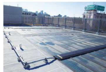
新宿リサイクル活動センター屋上 太陽電池
