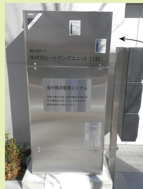
ヒートポンプユニット
