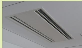
エントランスホールの天井に吹出し口があります。
